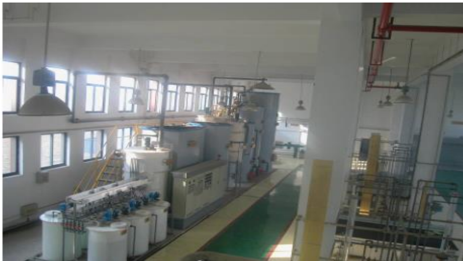
扬州大学废液处理系统
